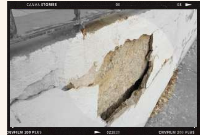
Décollement de l'enduit
